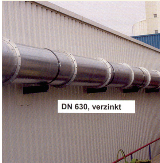
شکل ۱۱: لوله انتقال گازهای کربناتاسیون در قسمت خام
