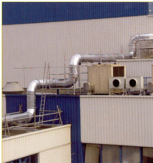
شکل ۱۲: لوله انتقال گازهای کربناتاسیون به نیروگاه
