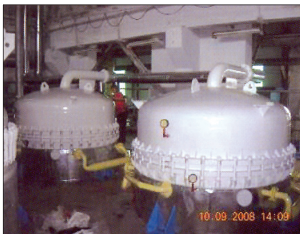
شکل ۱۳: فیلتر شمعی برای تصفیه شربت رقیق در فالستی
